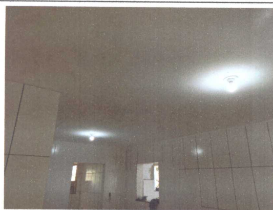
Ponto de iluminação no teto
