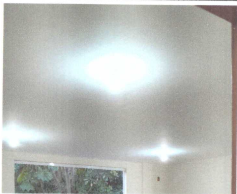
Ponto de iluminação no teto
