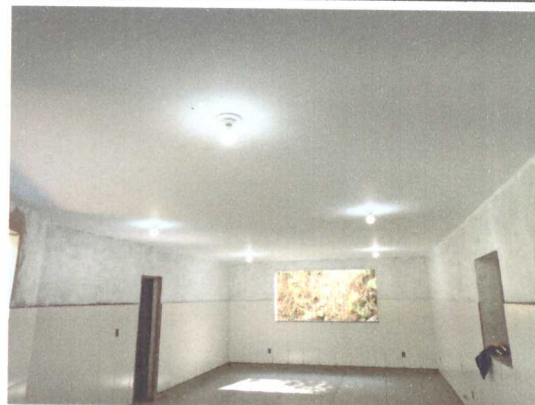
Ponto de iluminação no teto
