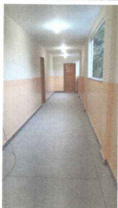
Ponto de iluminação no teto
